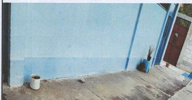
Foto 2: Las paredes tienen varios años de haberse pintado, estando evidenciado que ha cumplido su vida útil pues ha perdido el color y se desprende al momento de pegarse a las paredes.
