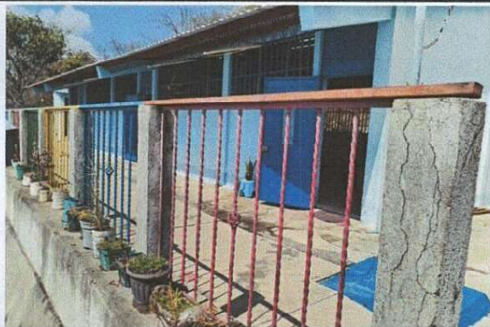
Foto 3: Existe una baranda de metal para evitar una posible caída de los niños desde el corredor de las aulas hacia el salón, así como el en baranda de las gradas, requiriendo mantenimiento o resane con pintura.
